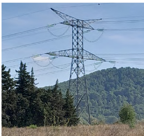
Photo d'un pylône treillis F44, issue du dossier de présentation et de proposition d'aire d'étude de la ligne aérienne à 2 circuits de 400 000 volts entre Fos-sur-mer et Jonquières-Saint Vincent – RTE
